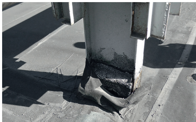
Рис. 4.22. Неправильное выполнение примыкания
