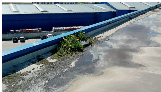
Рис. 4.6. Биологическое разрушение кровли
