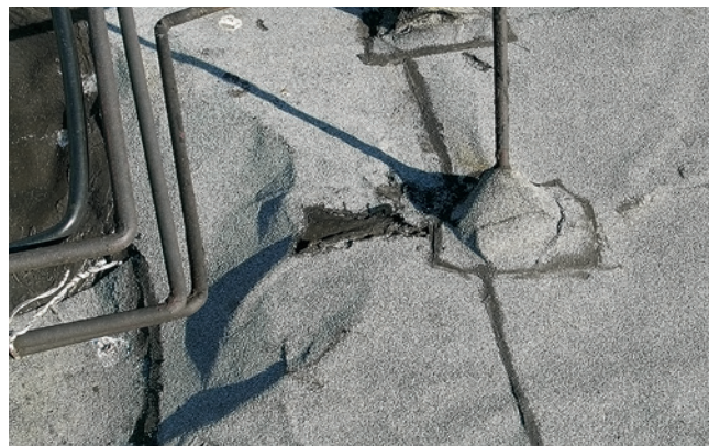
Рис. 4.19. Ошибки в устройствах примыкания к элементам крыши
