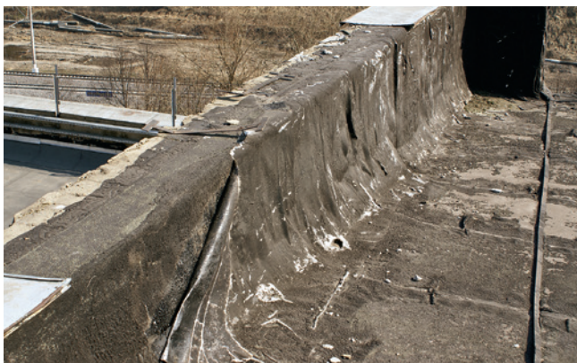
Рис. 4.13. Отсутствие элементов из оцинкованной стали
