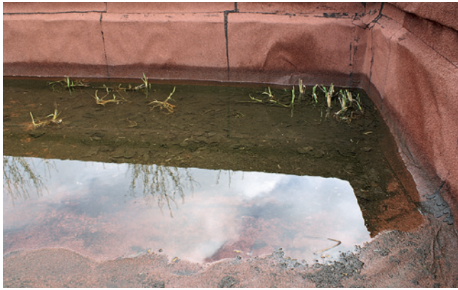
4.16. Засорение водоприемных воронок
