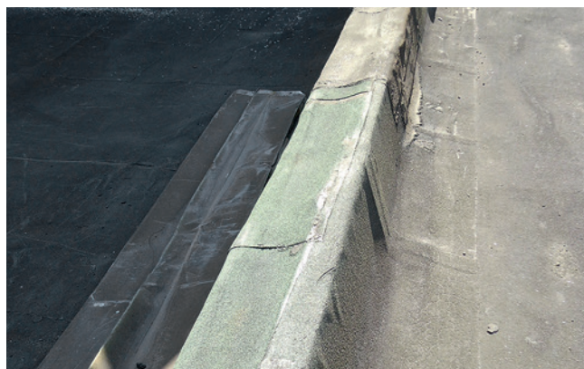
Рис. 4.20. Отсутствие защитного покрытия из оцинкованной стали на деформационном шве
