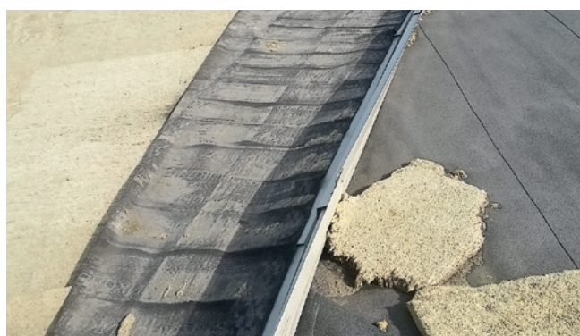
Рис. 4.1. Отрыв кровельного ковра от основания
