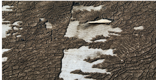
Рис. 4.9. Разрушение верхнего покровного слоя материала до основы
