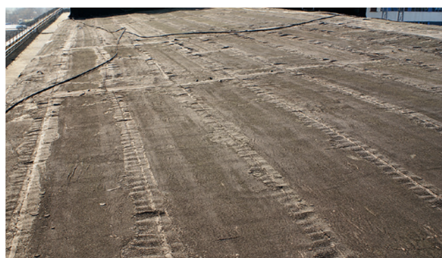
Рис. 4.2. Отсутствие защитной крупнозернистой посыпки
