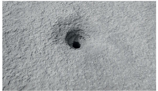
Рис. 4.18. Отсутствие защитных колпаков на водоприемных воронках
