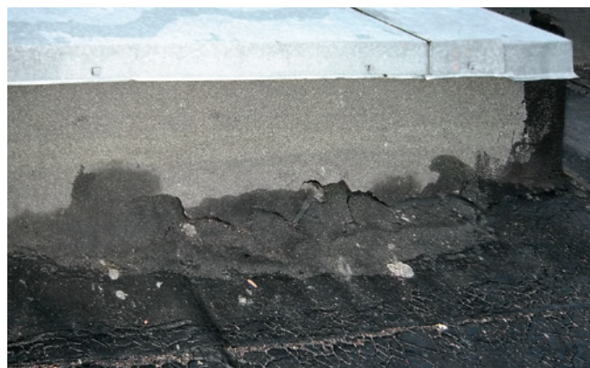
Рис. 4.11. Механическое повреждение кровли
