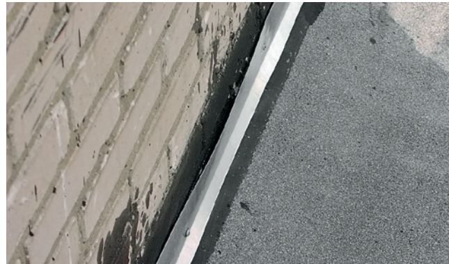
Рис. 4.14. Отсутствие герметика на верхнем отгибе защитного фартука
