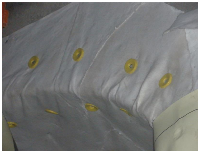
Рисунок 13.17 – Крепление геотекстиля на вертикальной поверхности с помощью саморезов и ронделей из ПВХ, точечное крепление ПВХ мембраны к ронделям.
