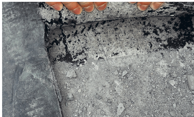
Рис. 3.6. Отсутствие адгезии материала к основанию из-за нанесения праймера на пыльную поверхность
