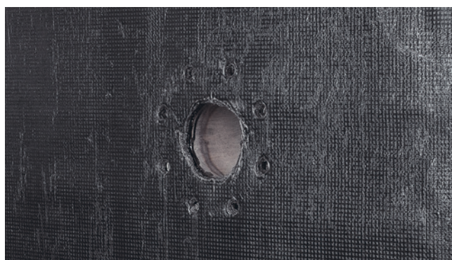
Рис. 6.12. Раскладка рулонов первого и второго слоя Техноэласт Фундамент в зоне трубной проходки
